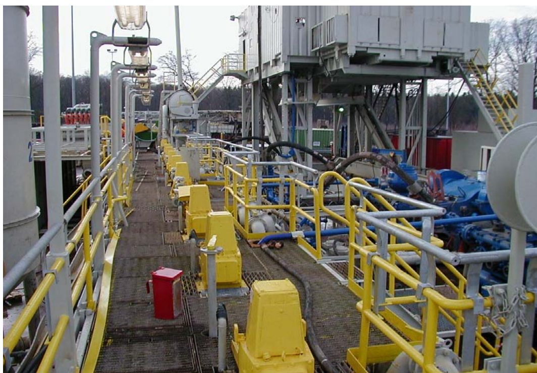
Bild 3: Tankanlage zur Reinigung Aufbewahrung und zur Anmischung von Spülung
